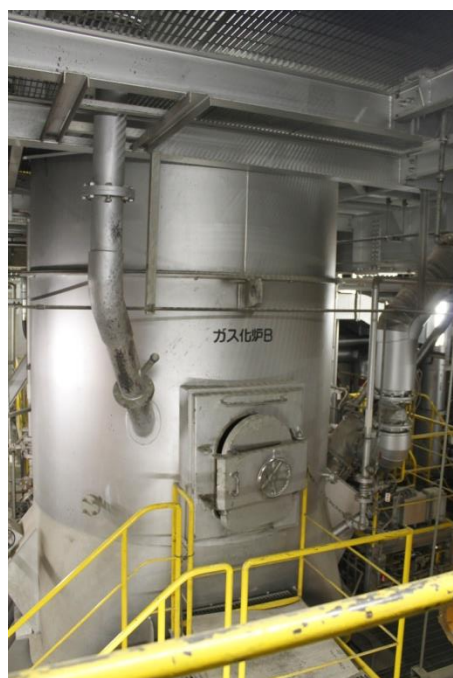
これが、ガス化溶融炉
