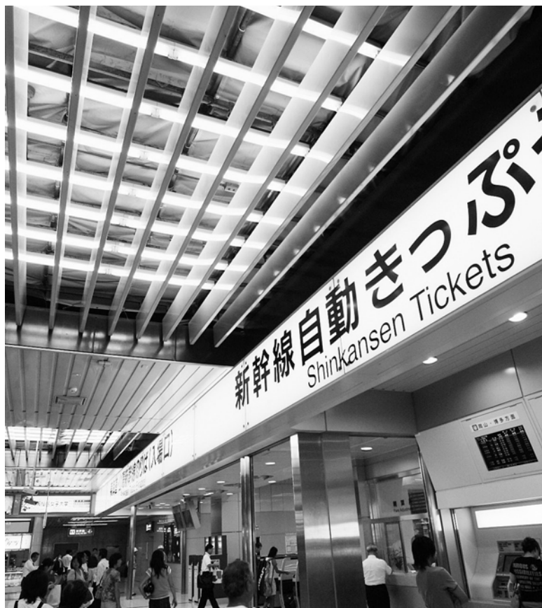
天井のシート(蛍光灯の上)のすき間からアスベストが見える、JR新大塚駅の3階中央コンコース 写真提供/時事(05年7月28日撮影)
